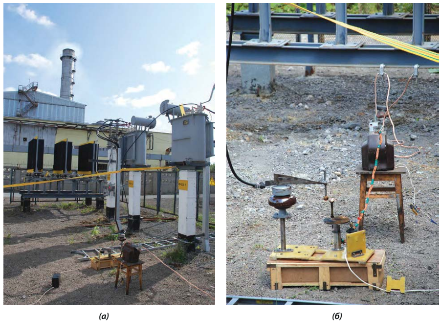
Рис. 6. Внешний вид подключения на фазу нейтраллера (а) искрового промежутка с шаровыми электродами и ТТ (б)
