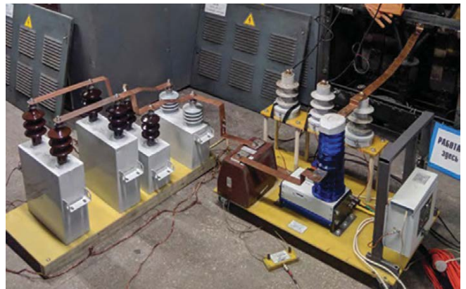
Рис. 8. Подключение к установке с однополюсным вакуумным выключателем высоковольтных конденсаторов для реализации «косвенного» метода определения тока ОЗЗ
