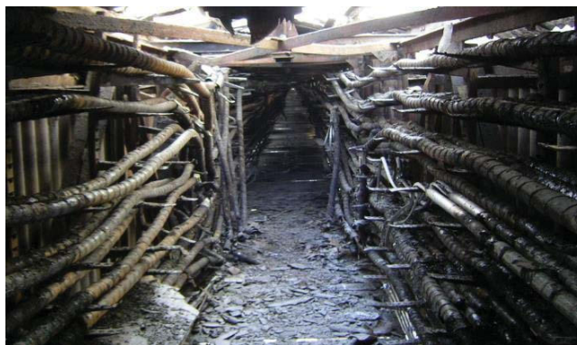
Рис. 1. Пожар в кабельном сооружении из-за возгорания силовых кабелей 10 кВ
