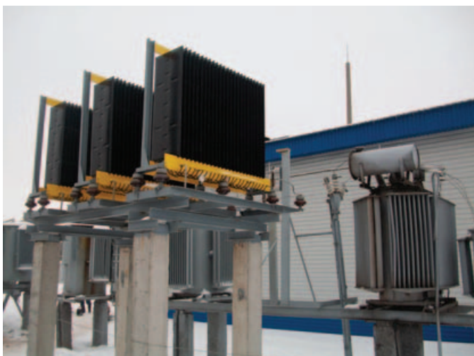
Рис. 4. Резистор РЗ-500-67-10 номинальным сопротивлением 500 Ом в сети 10 кВ подстанции Шёлковая филиала ОАО «МРСК Волги» — Оренбургэнерго
