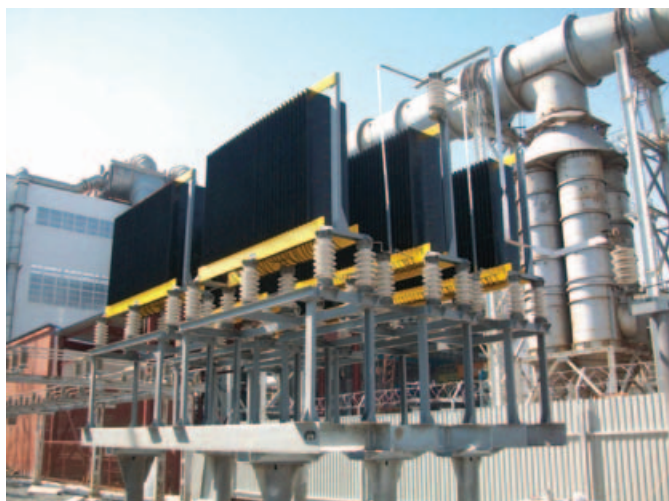
Рис. 5. Резистор РЗ-2700-151-35 номинальным сопротивлением 2700 Ом в сети 35 кВ (подстанция Трубная) схемы электроснабжения ОАО «Первоуральский новотрубный завод»
