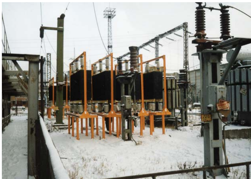
Рис.1. Резисторы РЗ-4000-102-35 на ОРУ ТЭЦ-3, питающей ОНПЗ
