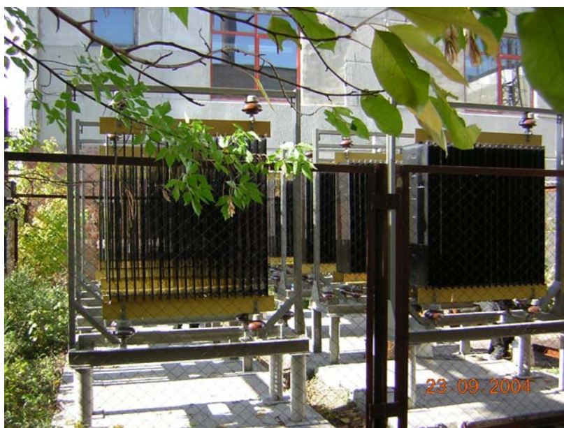
Рис.2 Резисторы РЗ-450-27-6 ГПП-220 1 очередь
