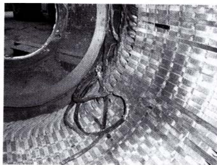
Рис. 1. Статор сгоревшего двигателя 630 кВ, вышедшего из строя в результате однофазного дугового замыкания на землю
